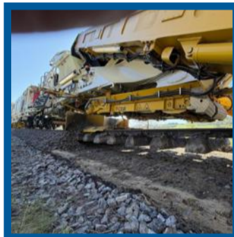
Hier schweben die Schwellen und das Gleis noch 20 Zentimeter über dem Boden. Im Hintergrund füllt die Maschine den reparierten Schotter wieder ins Bett. Foto: Bernd Eickhoff
